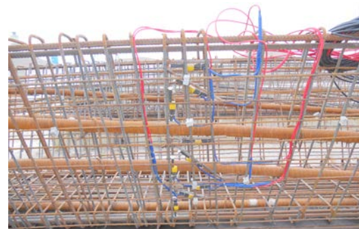
(d) Strain gage impeded in the girder
