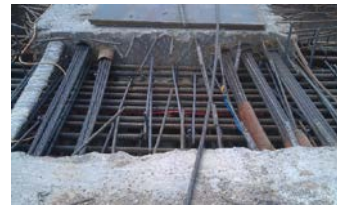
(d) Continuity cables top view
